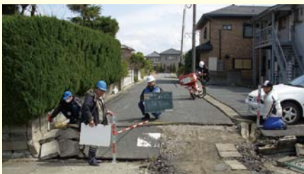
潮来市の道路被害調査
